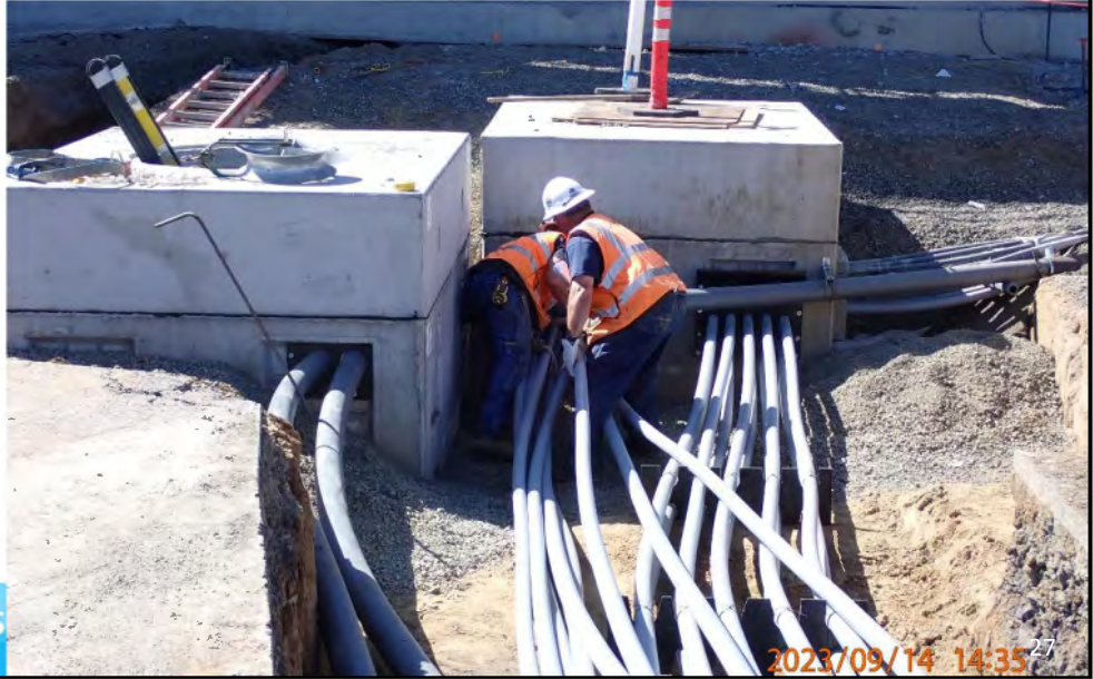
Upper Site electrical conduits / duct banks
