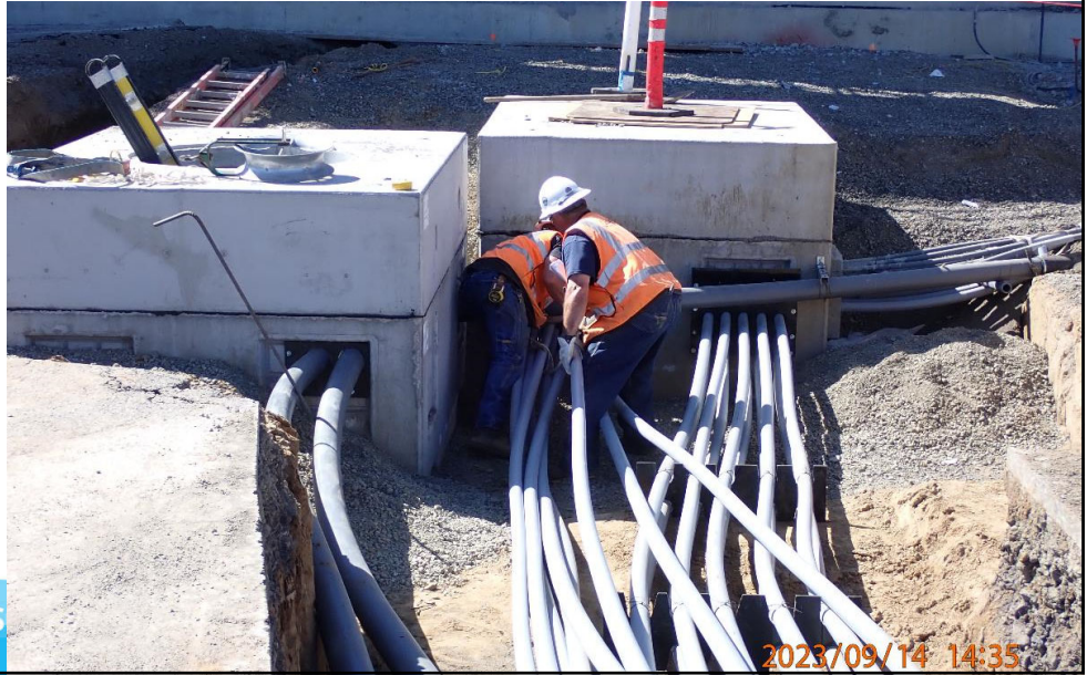
Upper Site electrical conduits / duct banks
